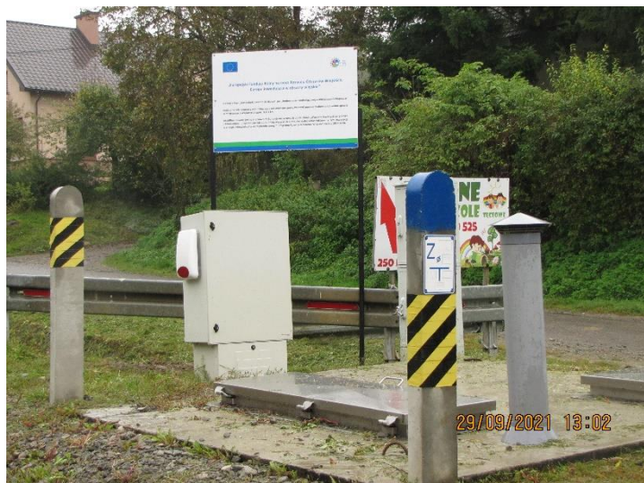
Pompownia w Wapowcach.
